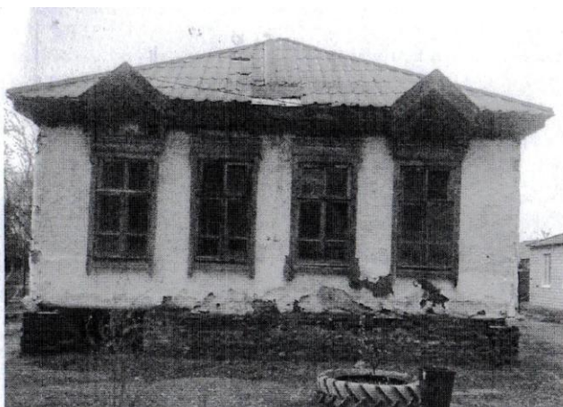
Здание 1890года, требуется капитальный ремонт.
